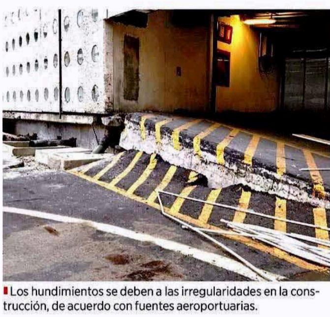
Los hundimientos se deben a las irregularidades en la construcción, de acuerdo con fuentes aeroportuarias.
